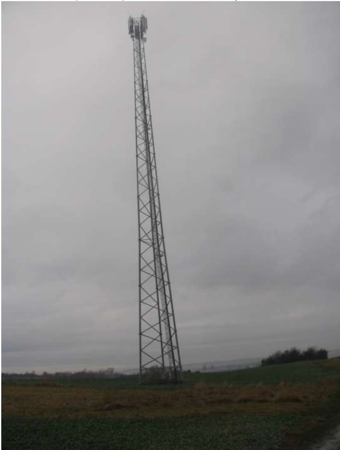
Załącznik nr 1: Widok ogólny instalacji radiokomunikacyjnej.
